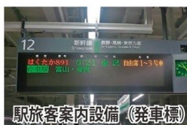
駅旅客案内設備 (発車標) 駅や沿線設備への電源供給設備、照明設備のほか、旅客案内設備 (発車標) などの駅設備から構成されます。敦賀駅は3階建ての大きな駅で、電源供給規模が大きいことから、駅構内に配電所が3つ設備されます。
